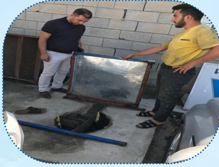
Ön Arıtma Sisteminin Kontrolü
